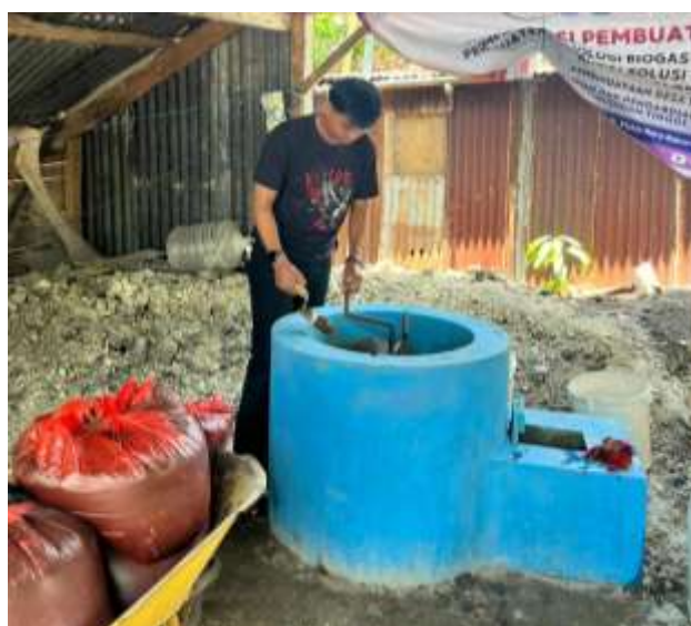
Gambar 1 . Proses pemasukan kotoran ternak pada digaster biogas
